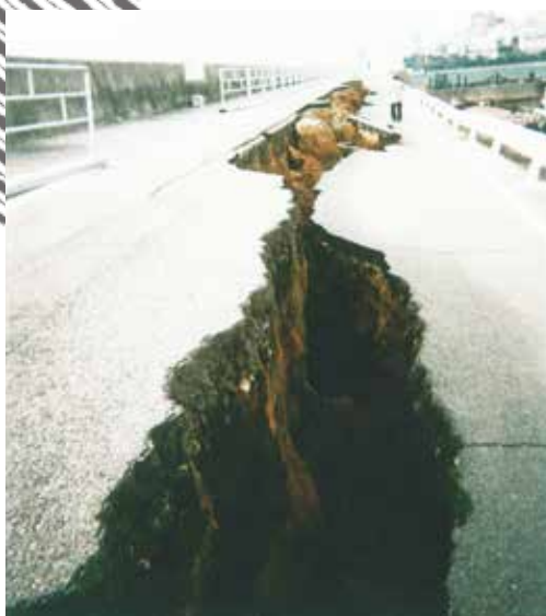
淀川右岸堤防は西島付近で750mにわたって大きく地割れ。道路右半分が最大2m落下
