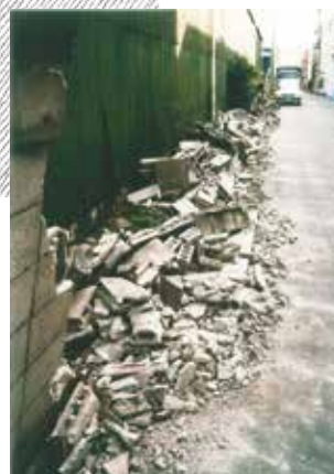
塀の倒壊が区内各所で見られた(写真は御幣島5丁目の工場の塀)
