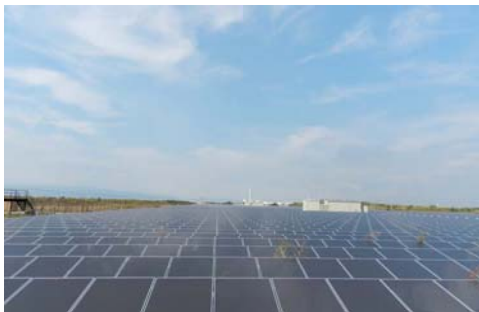
堺太陽光発電所
