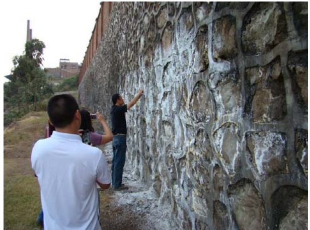
化工厂围墙渗漏
