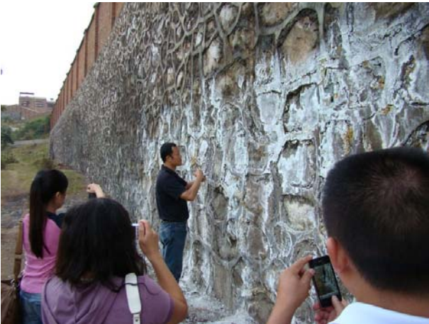
陆良化工厂外墙渗出的毒粉
