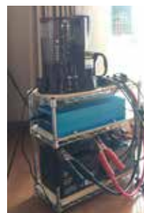
バッテリーやインバーターなどの室内機器一式
