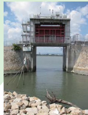
高潮対策の伝法水門
